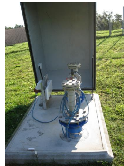
Kilde: Dråby Vandværk. Råvandsstation.
