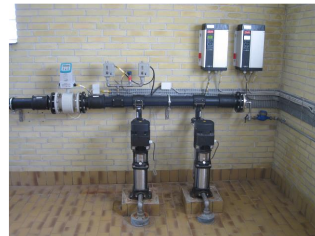
Kilde: Rønde Vandværk. Udpumpningsanlæg.
