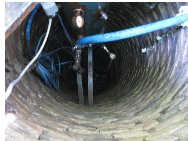
Kilde: Ikke-almment vandværk. Tørbrønd.
