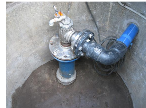
Kilde: Mørke Stationsby Vandværk. Tørbrønd.
