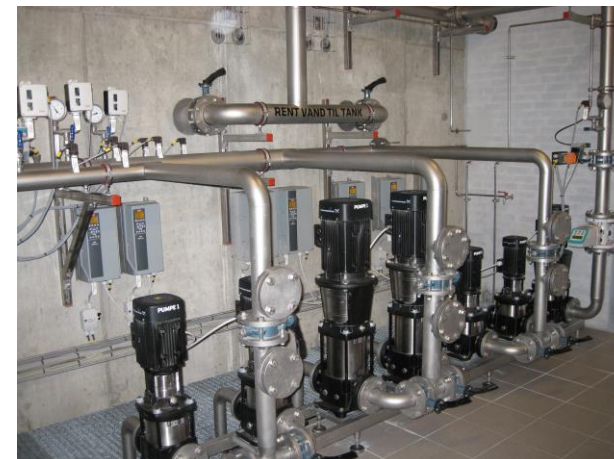
Kilde: Djurs Vand, Handrup-Bakker. Rentvandspumper.
