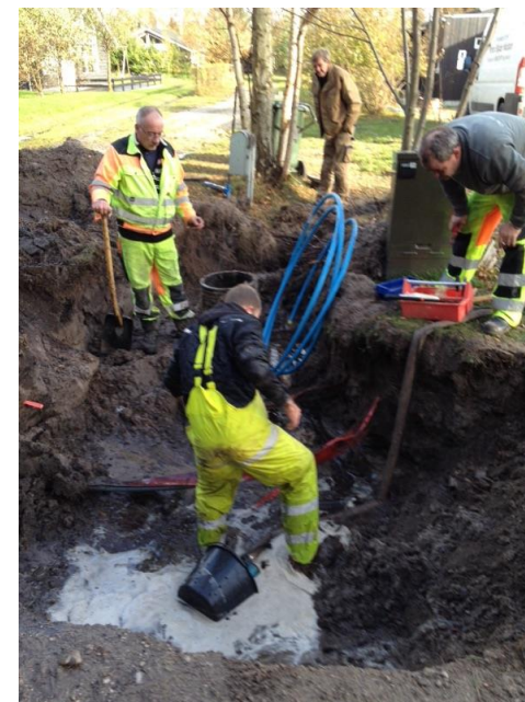
Kilde: Hasnæs Vandværk. Ledningsbrud.
