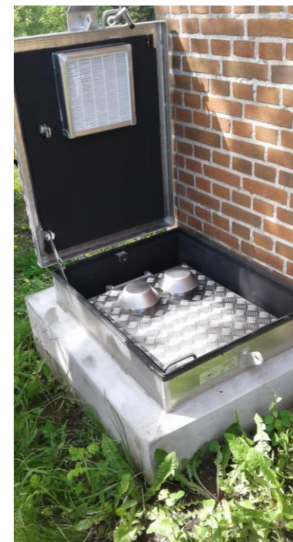
Kilde: Stødov Vandværk. Nedgang til beholderanlæg.
