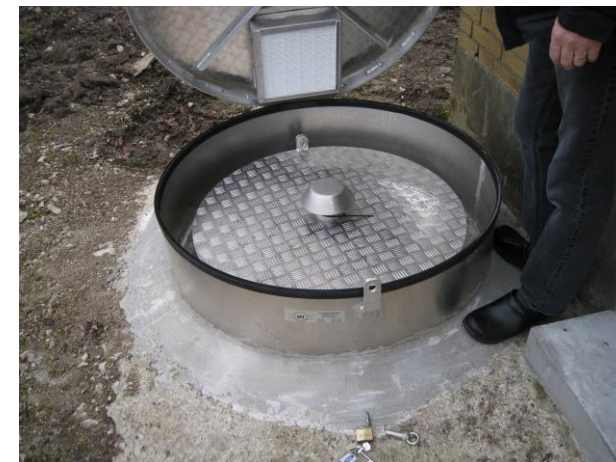
Kilde: Termestrup Vandværk. Nedgang til rentvandsbeholder.
