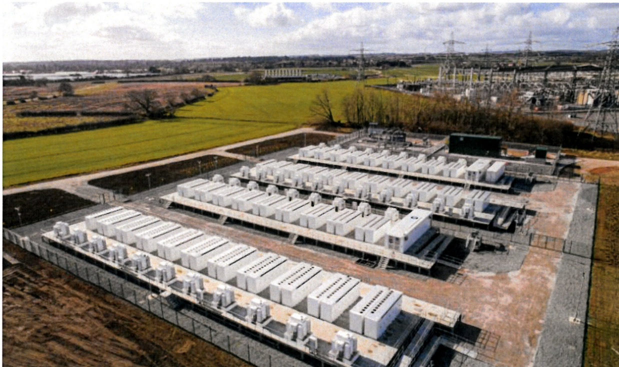
(Eksempel på BESS-anlæg)
